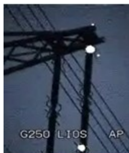
Рис. хх. Сильное загрязнение стержневой фарфоровой изоляции ВЛ 750 кВ. Получено камерой DayCor II [6]
