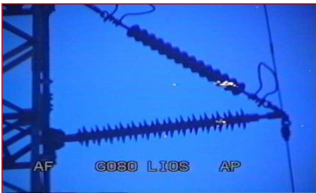
Рис. хх. Сильное загрязнение стержневой фарфоровой и полимерной изоляции ВЛ 250 кВ. Получено камерой DayCor II [5]
